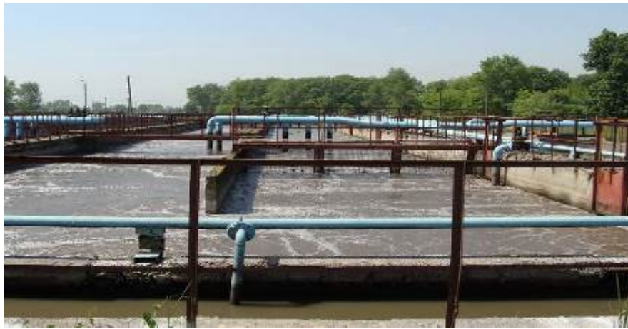
Рис. 138. Очисні споруди КП «Чернігівводоканал»
